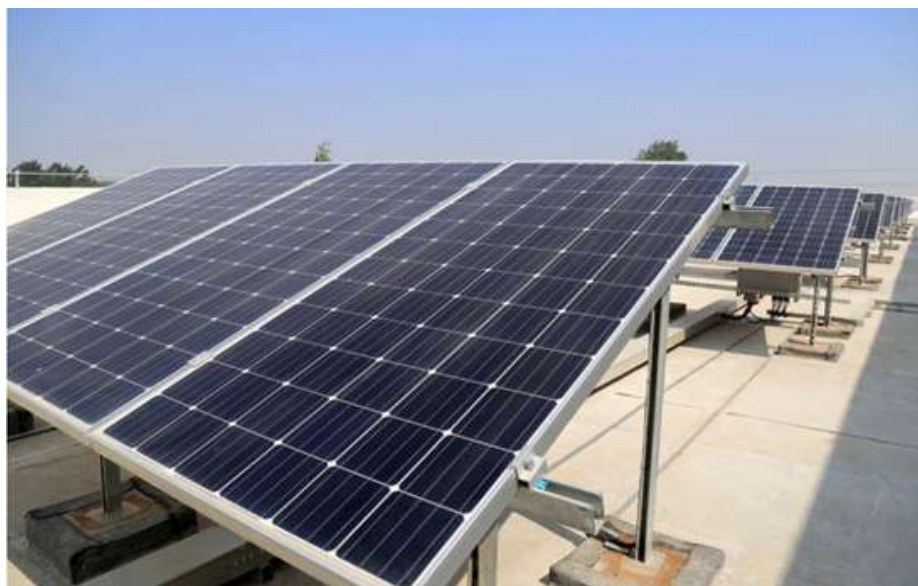
Рисунок 4.20 - Зовнішній вигляд розміщення СЕС на даху багатоквартирного будинку
