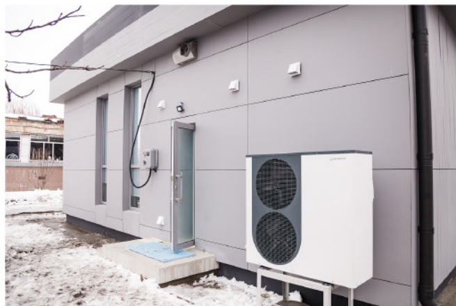
Технологія рекуперації утилізує до 95% тепла повітря
