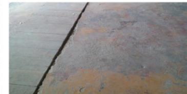
Підлога до ремонту
