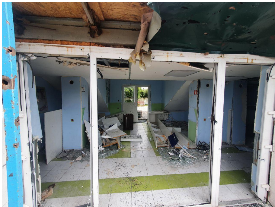
Фото 9.1 – пошкодження внутрішнього оздоблення приміщень будівлі трибуни
