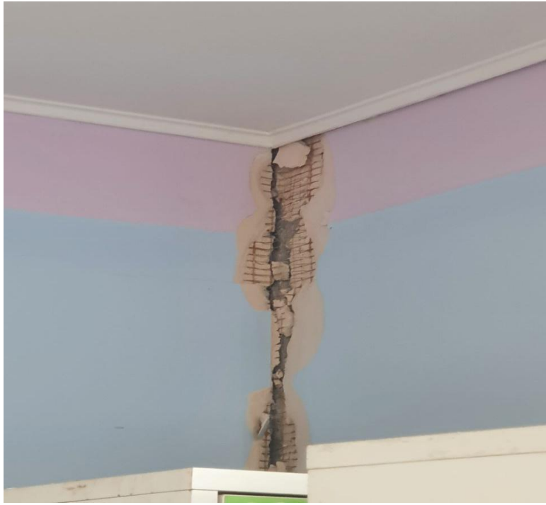
Фото 9.3 – пошкодження оздоблення стіни роздягальні №1
