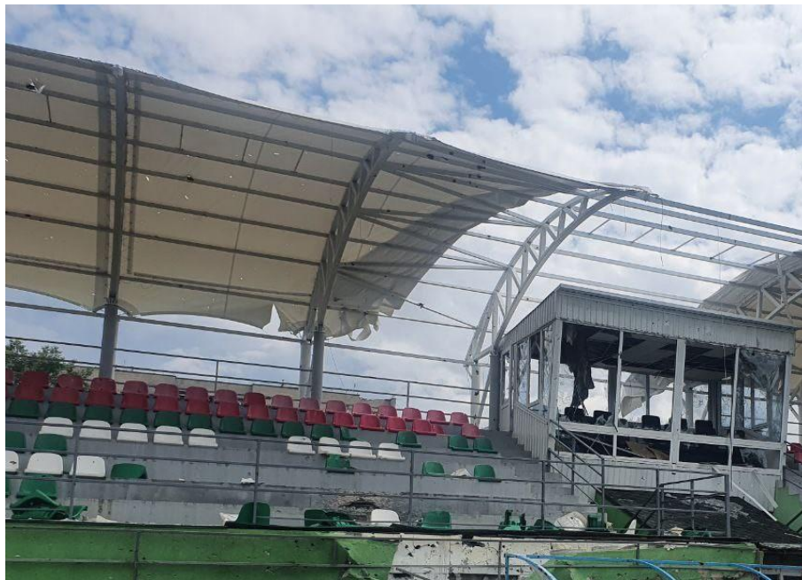
Фото 6.2 – пошкодження металевих конструкцій навісу над трибуною та накриття навісу
