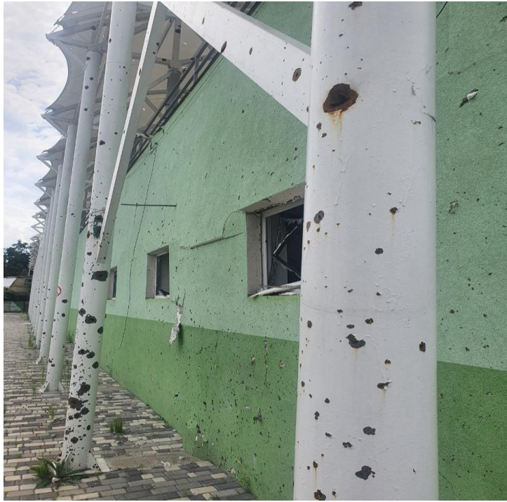
Фото 6.1 – пошкодження металевих колон навісу трибуни
