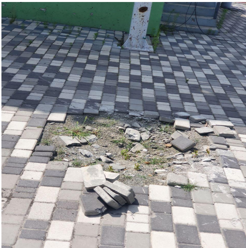
Фото 17.1 – руйнування тротуарної плитки
