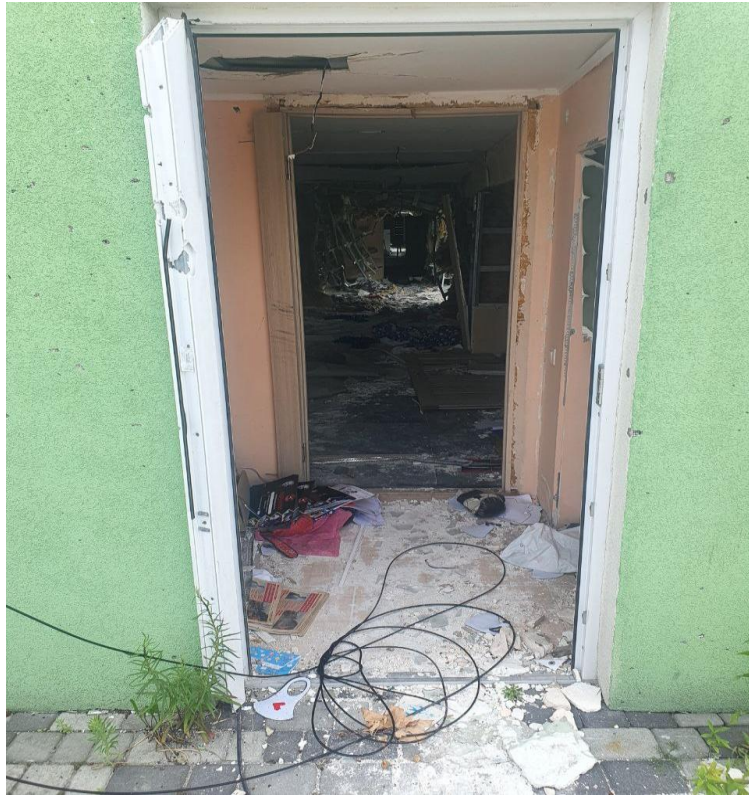
Фото 7.3 – пошкодження дверних блоків
