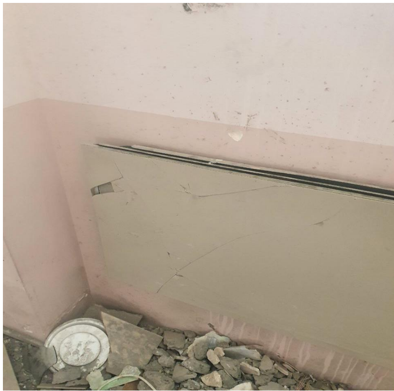
Фото 11.1 – пошкодження електричного конвектору
