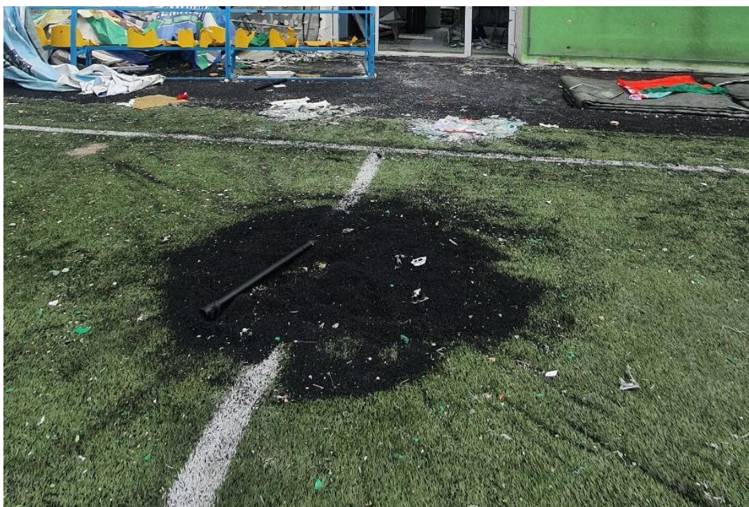
фото 14.1 – пошкодження штучного покриття футбольного стадіону
