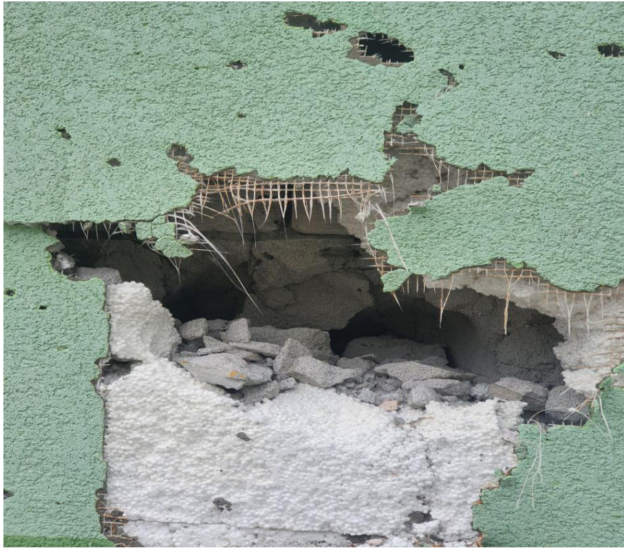
Фото 3.3 – пошкодження утеплення та оздоблення стіни будівлі трибуни
