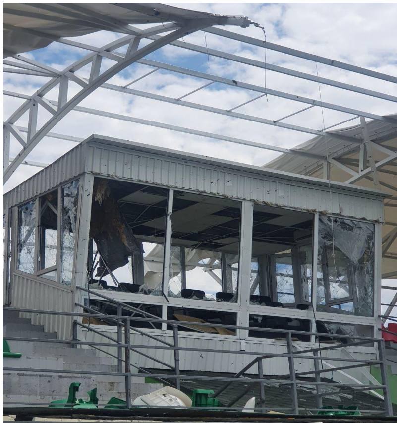
Фото 8.1 – руйнування скління конструкцій трибуни
