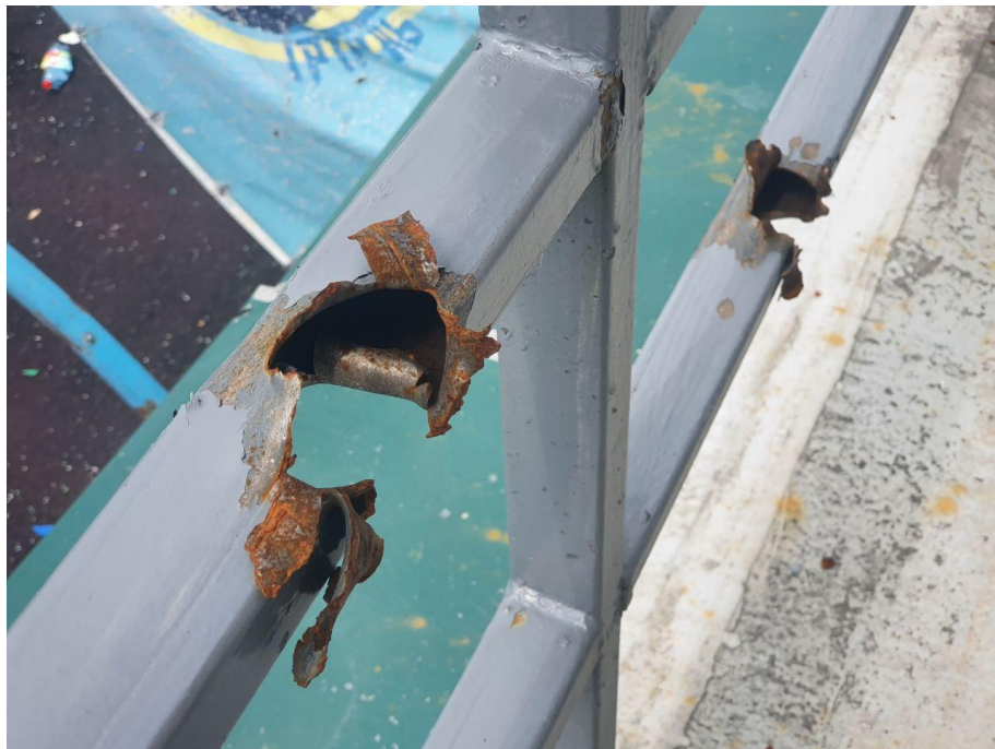
Фото 13.1 – пошкодження поручнів трибуни
