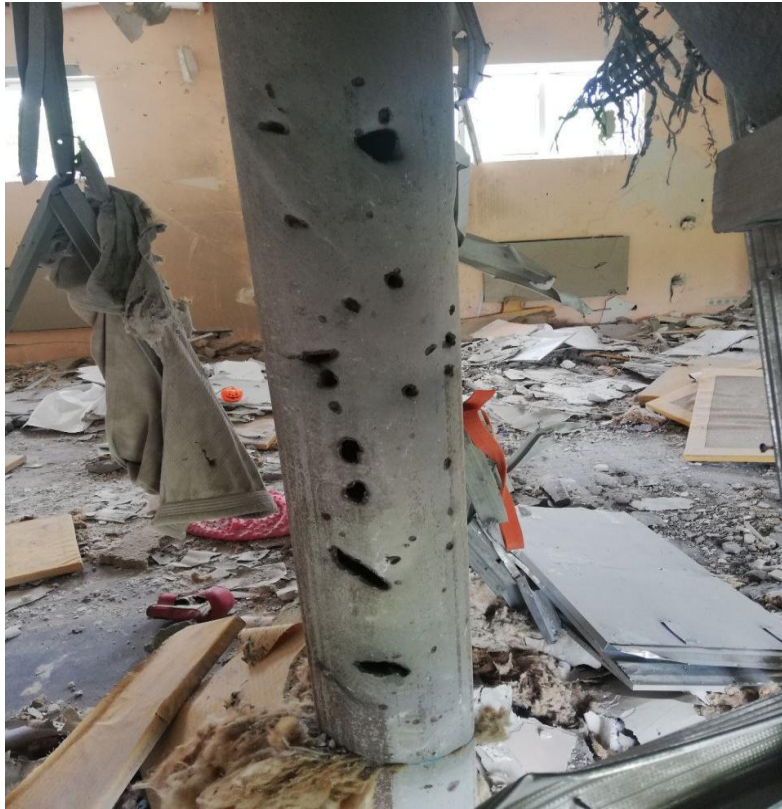
Фото 5.3 – пошкодження несучої колони будівлі
