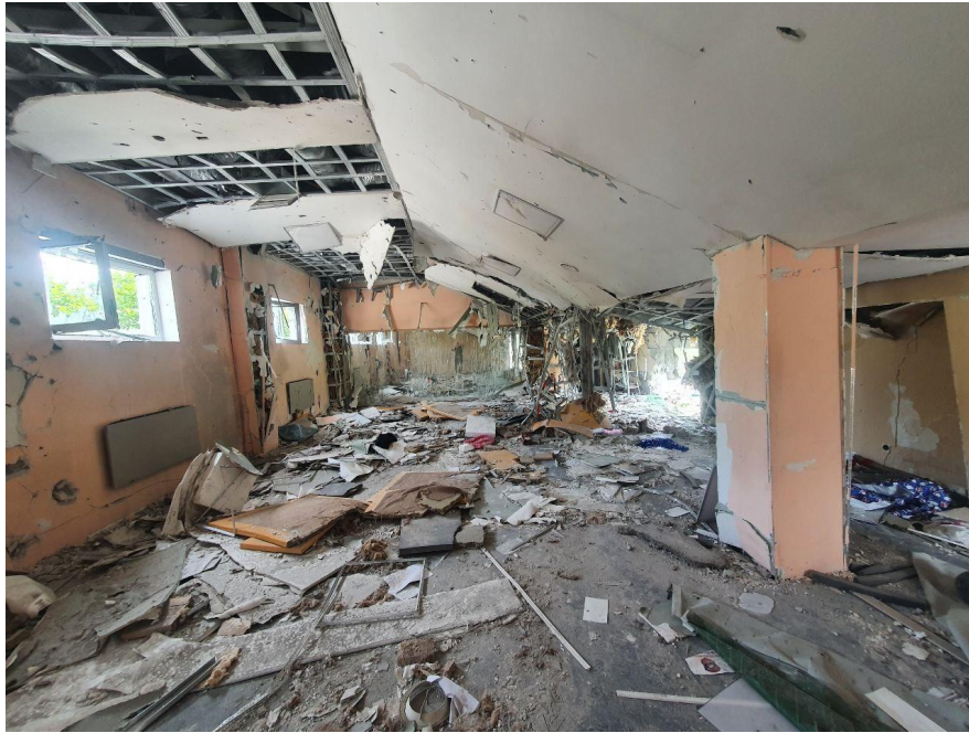
Фото 9.5 – пошкодження з руйнуванням оздоблення приміщення спортзалу
