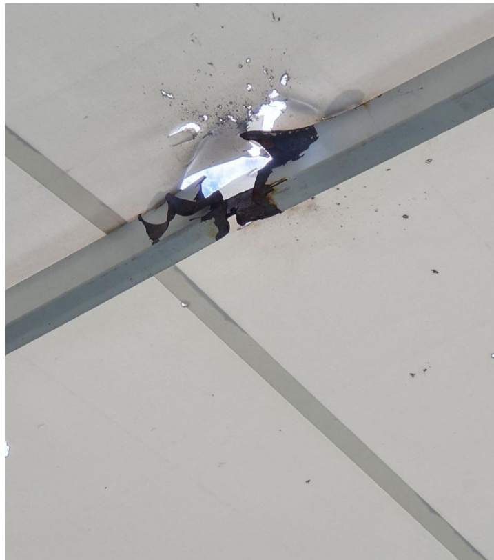
Фото 6.4 – пошкодження металевої конструкції навісу трибуни
