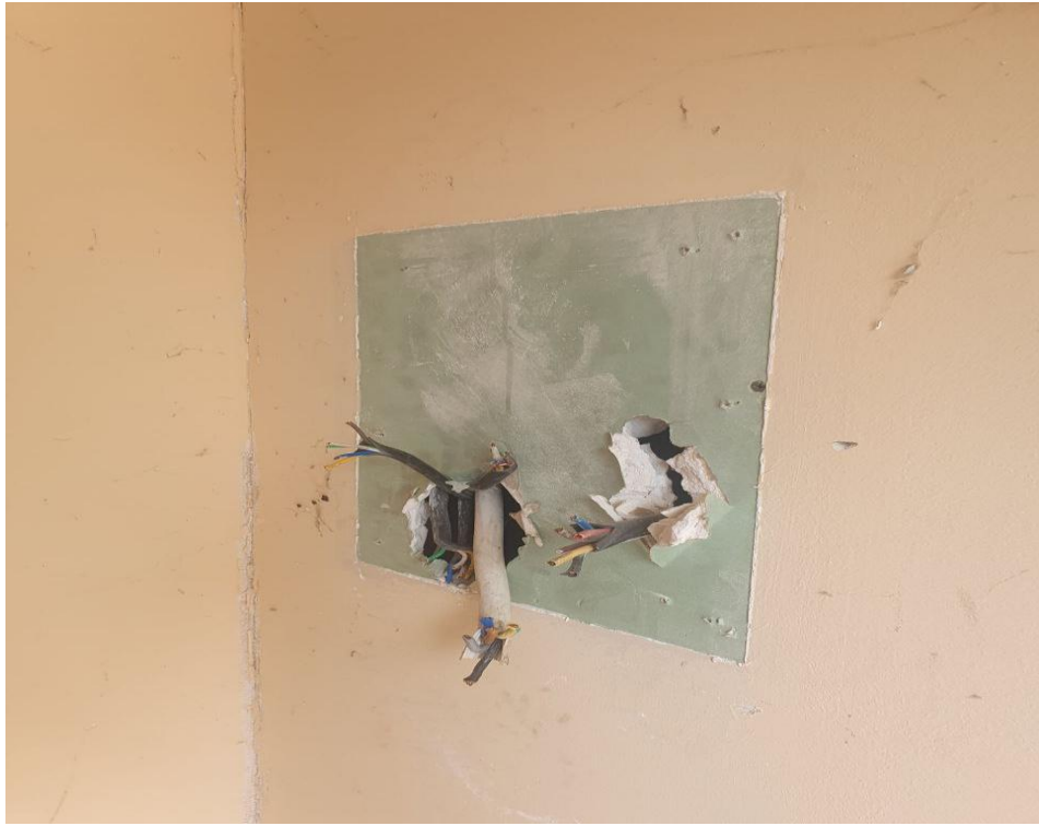
Фото 10.1 – пошкодження мереж електропостачання
