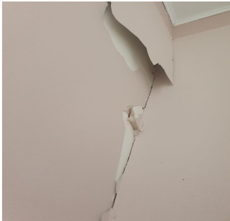
Фото 9.6 – пошкодження штукатурки стіни роздягальні №3
