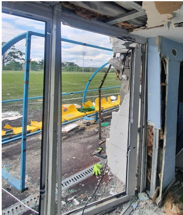
Фото 7.2 – пошкодження дверного блоку, руйнування скління
