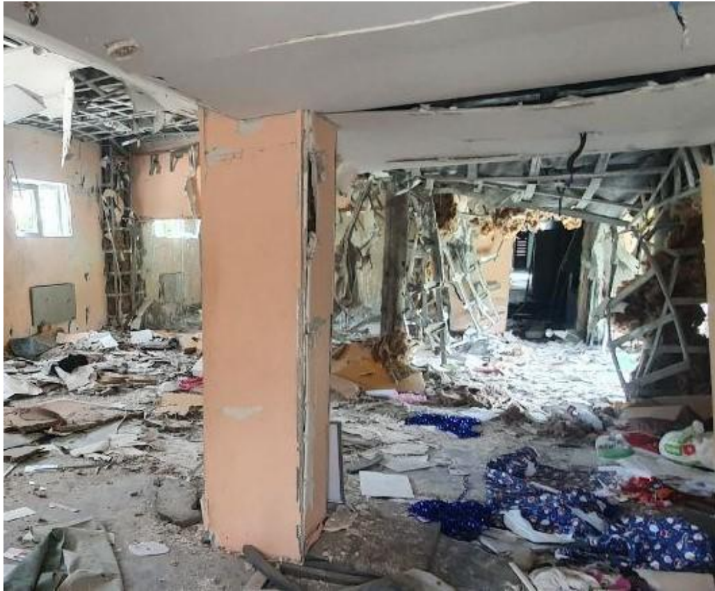
Фото 5.1 – пошкодження несучих колон будівлі трибуни
