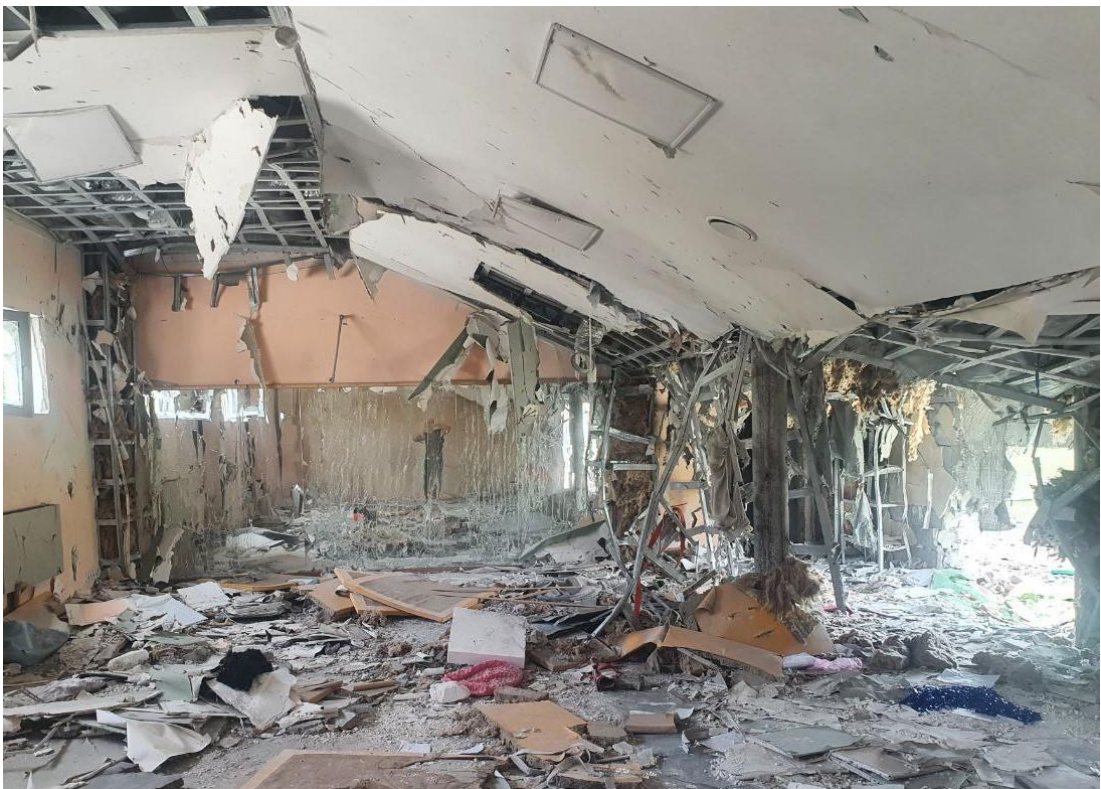
Фото 5.2 – пошкодження колон будівлі трибуни
