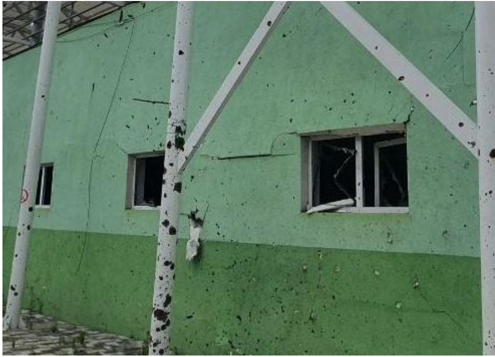
Фото 7.1 – пошкодження віконних блоків, руйнування скління
