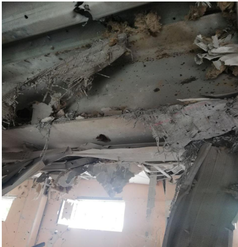
Фото 5.4 – пошкодження каркасу будівлі
