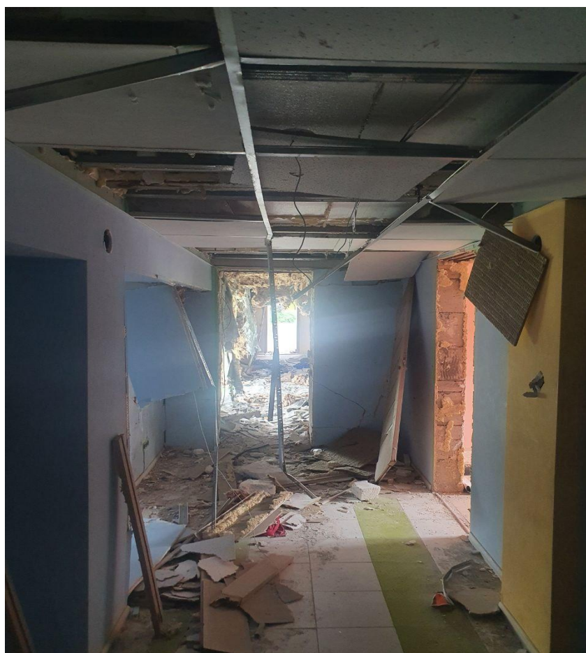
Фото 9.2 – пошкодження внутрішнього оздоблення приміщень будівлі трибуни
