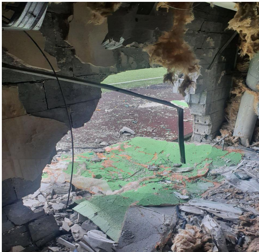
Фото 4.3 – руйнування огорожувальних конструкцій будівлі трибуни
