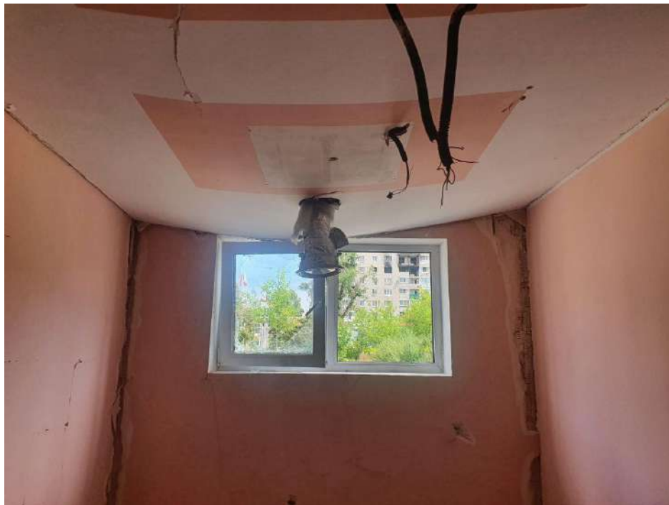
Фото 9.4 – пошкодження оздоблення приміщень кабінету тренера
