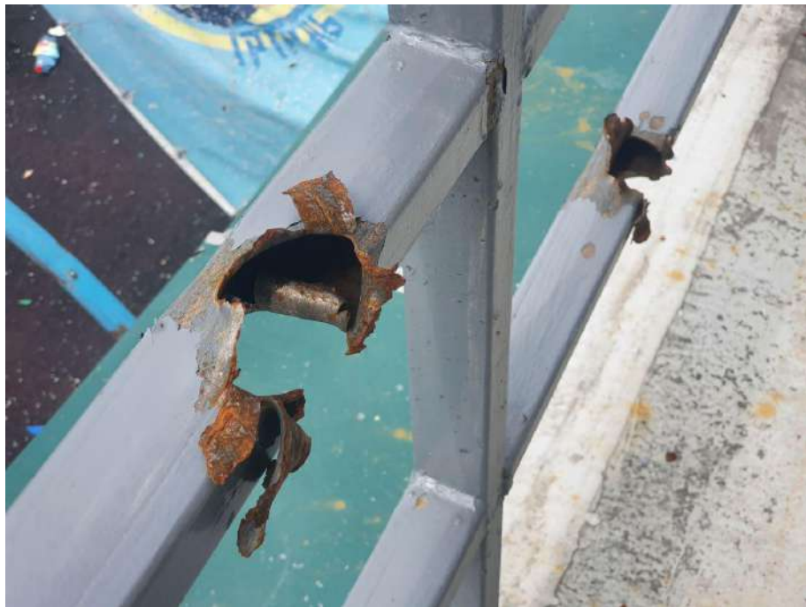
Фото 13.1 – пошкодження поручнів трибуни
