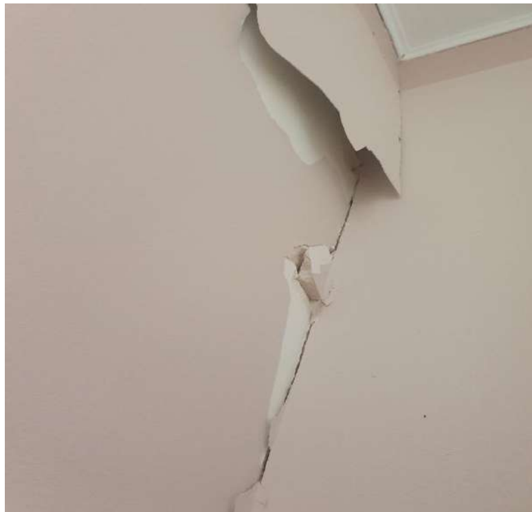
Фото 9.6 – пошкодження штукатурки стіни роздягальні №3
