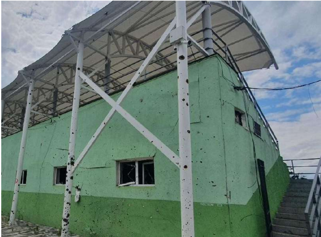
Фото 3.1 – пошкодження фасадів та металевих колон навісу будівлі трибуни
