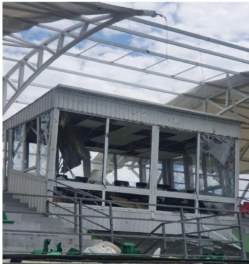
Фото 8.1 – руйнування скління конструкцій трибуни
