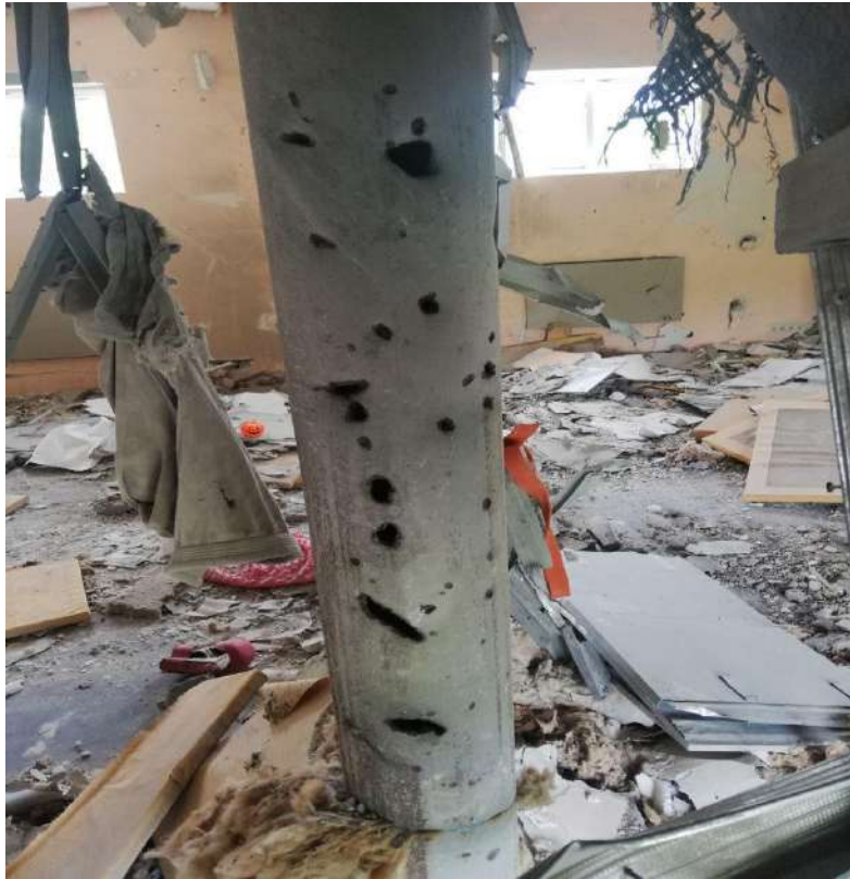
Фото 5.3 – пошкодження несучої колони будівлі
