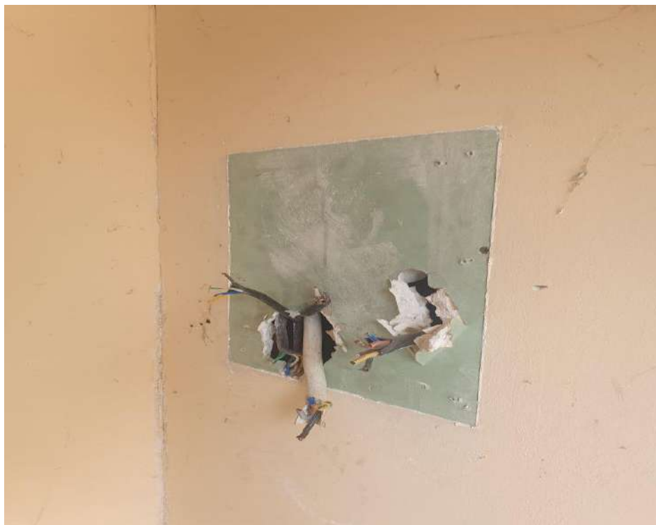
Фото 10.1 – пошкодження мереж електропостачання
