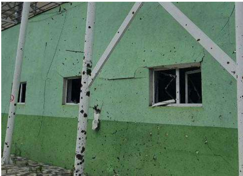
Фото 7.1 – пошкодження віконних блоків, руйнування склінняя
