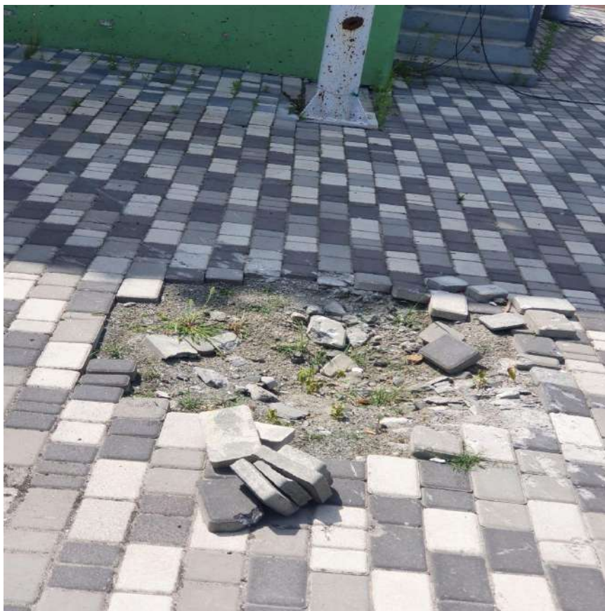
Фото 17.1 – руйнування тротуарної плитки
