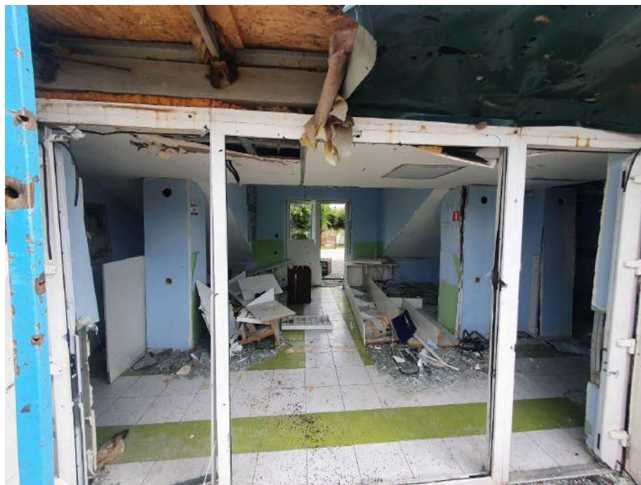
Фото 9.1 – пошкодження внутрішнього оздоблення приміщень будівлі трибуни
