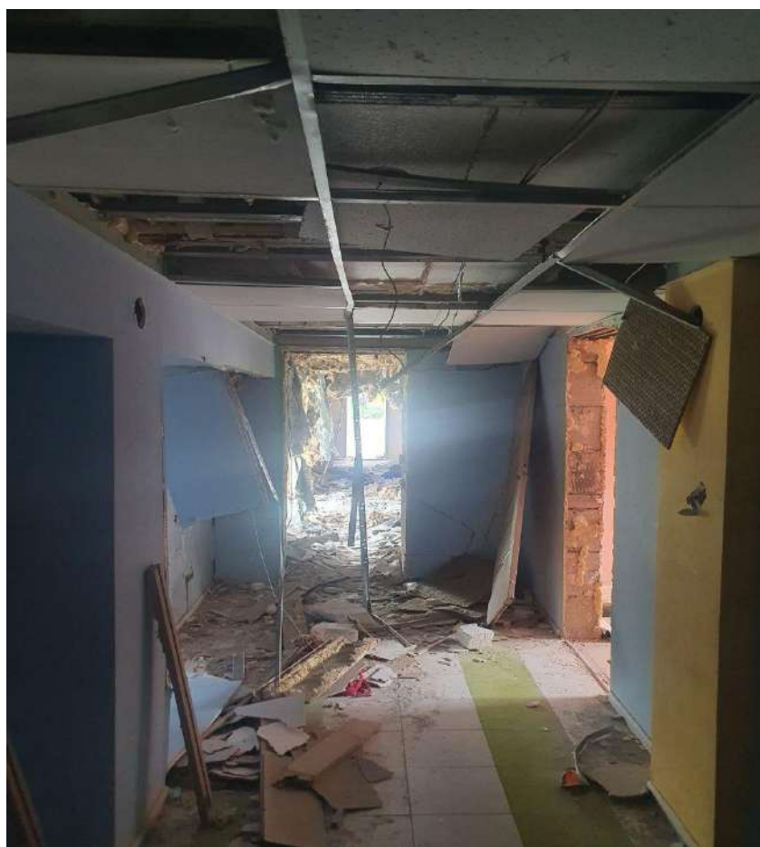
Фото 9.2 – пошкодження внутрішнього оздоблення приміщень будівлі трибуни
