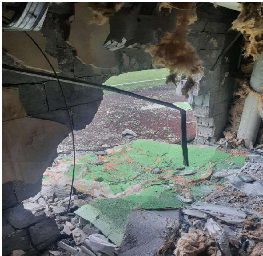
Фото 4.3 – руйнування огорожувальних конструкцій будівлі трибуни
