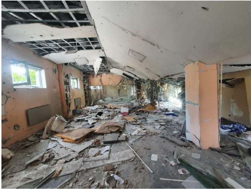
Фото 9.5 – пошкодження з руйнуванням оздоблення приміщення спортзалу
