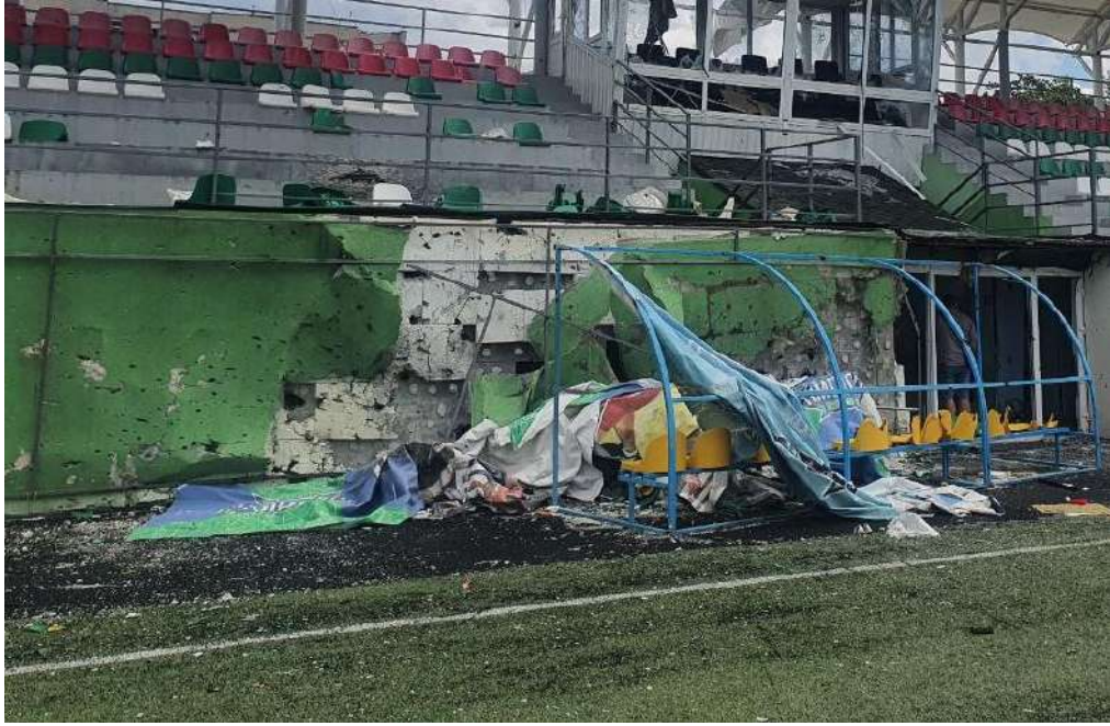
Фото 4.2 – руйнування огорожувальних конструкцій будівлі трибуни внаслідок влучання снаряду
