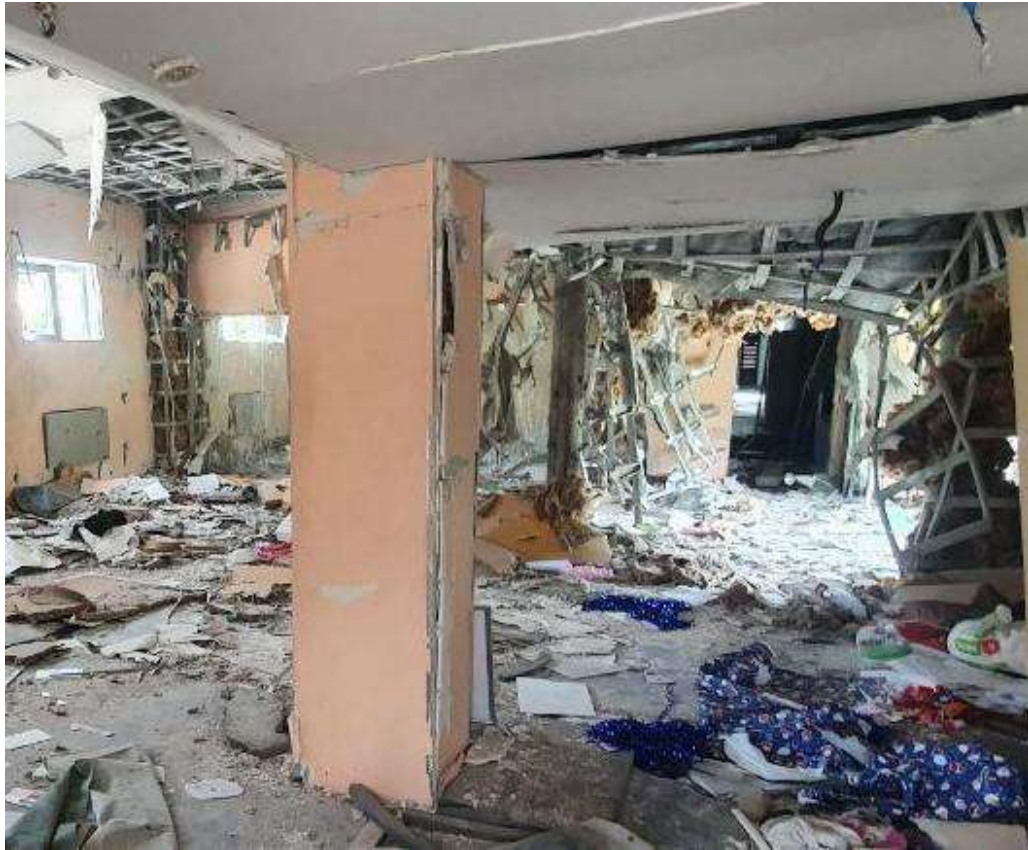
Фото 5.1 – пошкодження несучих колон будівлі трибуни
