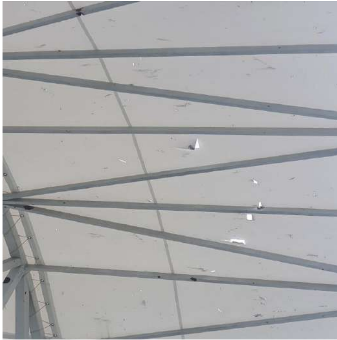
Фото 6.3 – пошкодження металевих конструкцій навісу над трибуною, отвори у накритті навісу
