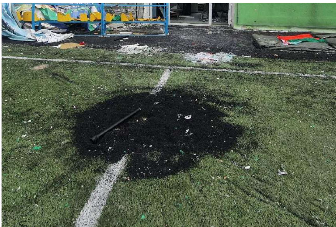
фото 14.1 – пошкодження штучного покриття футбольного стадіону
