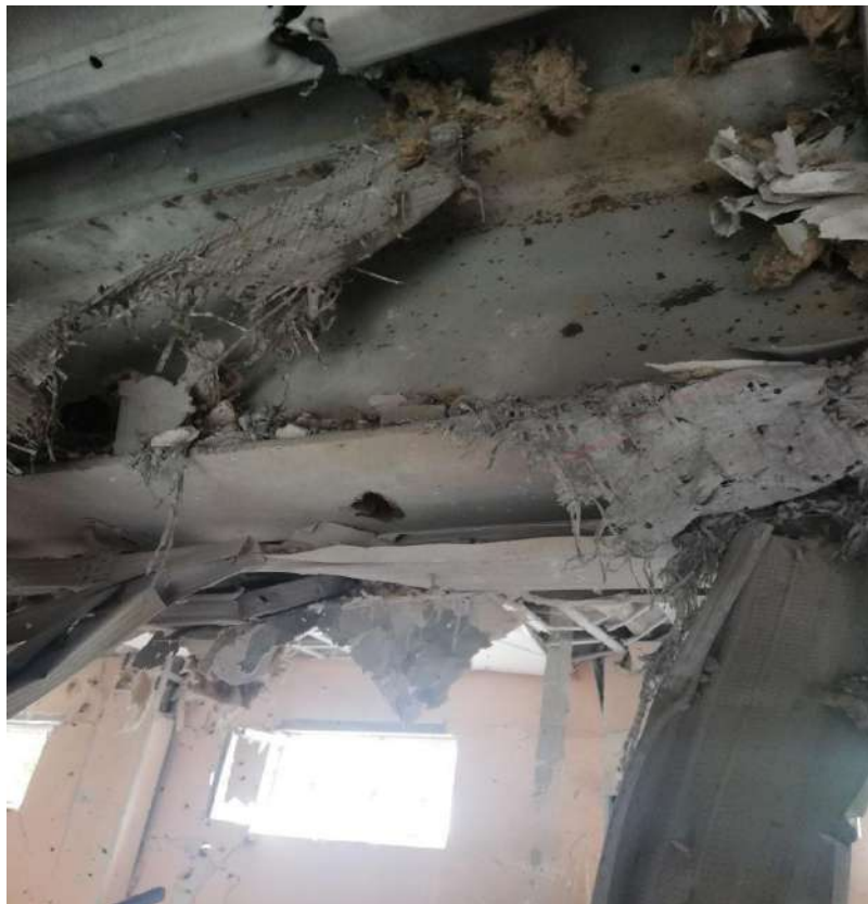
Фото 5.4 – пошкодження каркасу будівлі
