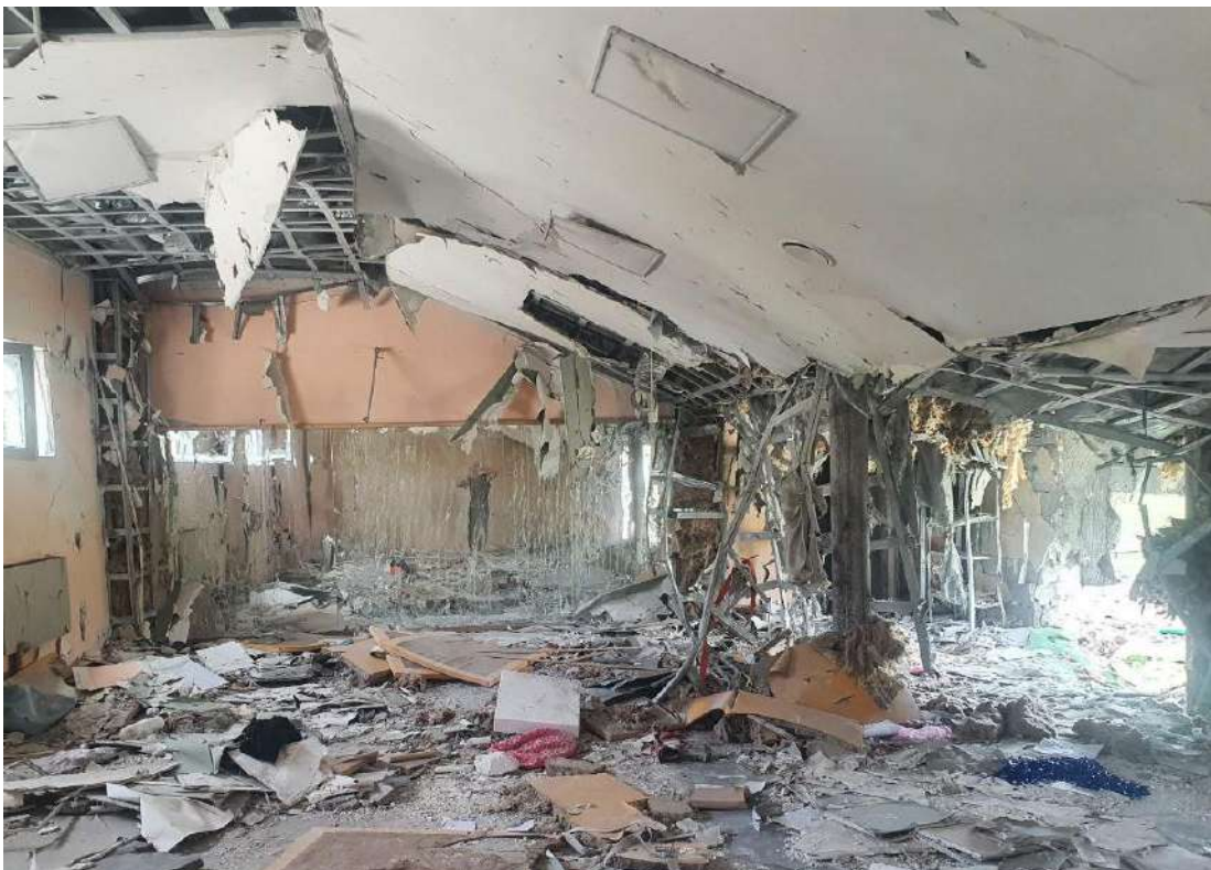
Фото 5.2 – пошкодження колон будівлі трибуни
