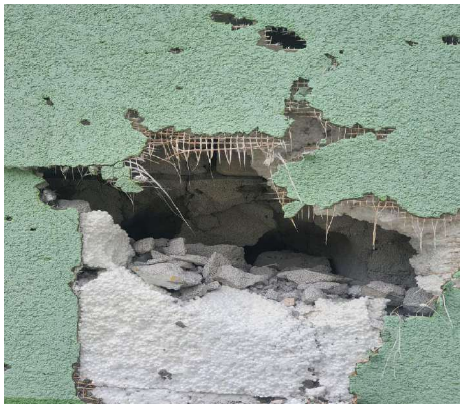
Фото 3.3 – пошкодження утеплення та оздоблення стіни будівлі трибуни
