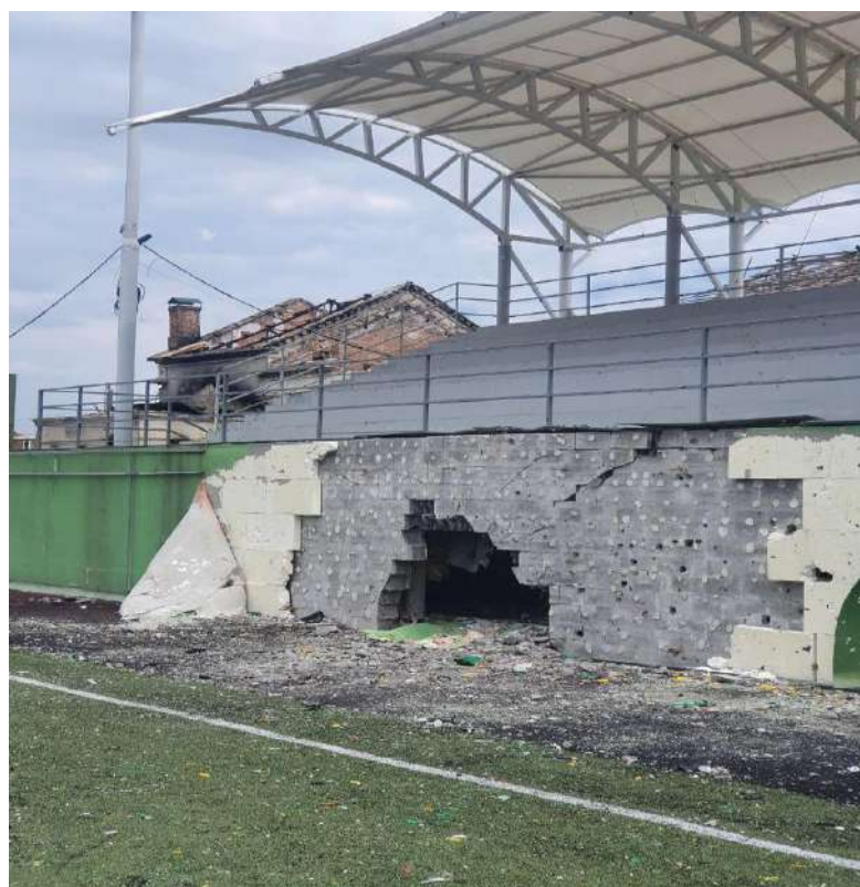
Фото 4.1 – руйнування огорожувальних конструкцій будівлі трибуни внаслідок влучання снаряду
