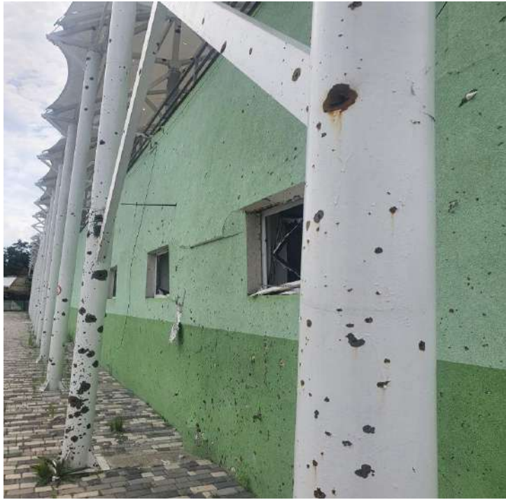
Фото 6.1 – пошкодження металевих колон навісу трибуни
