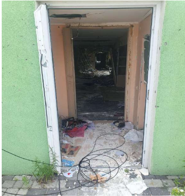
Фото 7.3 – пошкодження дверних блоків
