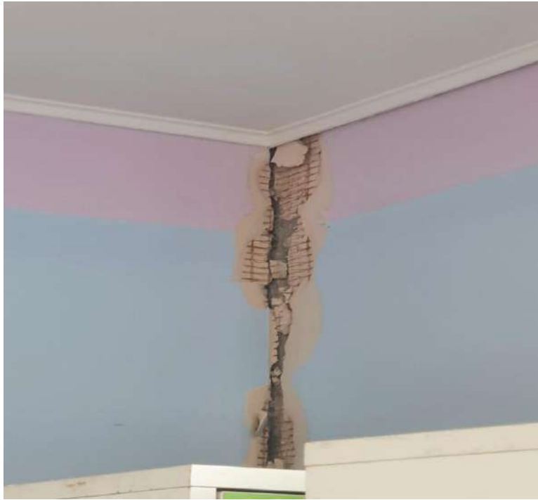
Фото 9.3 – пошкодження оздоблення стіни роздягальні №1
