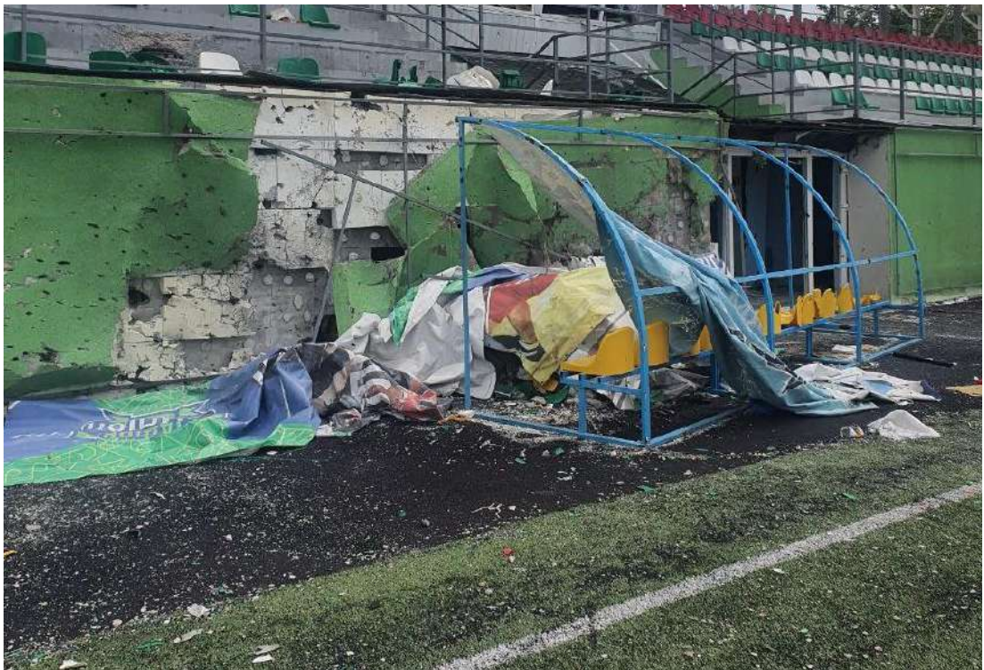
Фото 3.2 – локальне руйнування шару утеплення та оздоблення несучих конструкцій будівлі трибуни
