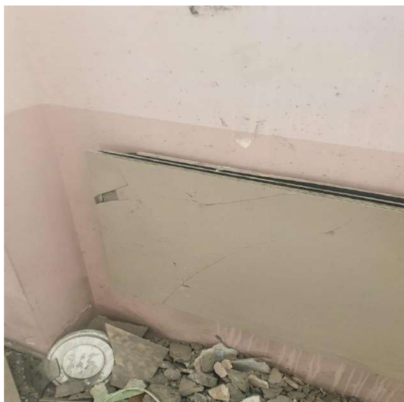
Фото 11.1 – пошкодження електричного конвектору
